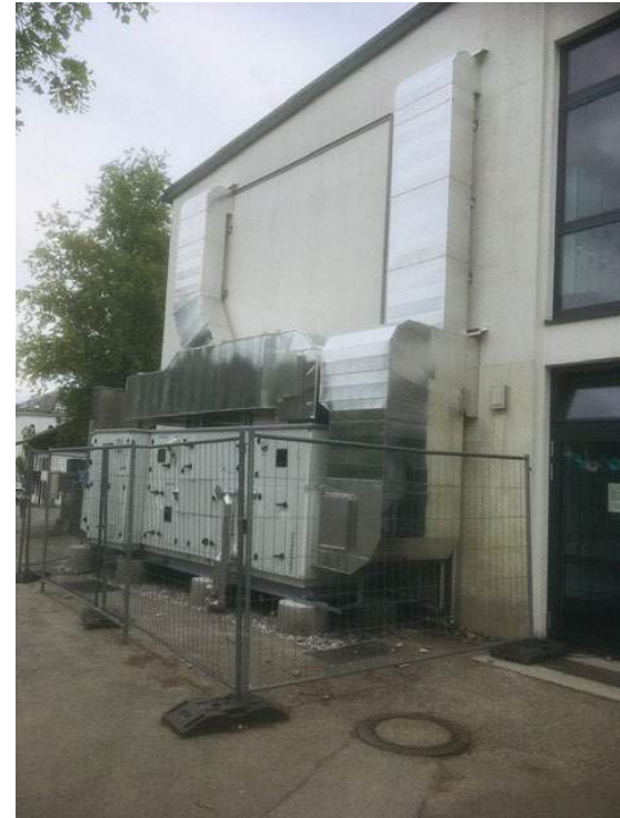
Lüftungsanlage – Traubinger Straße
