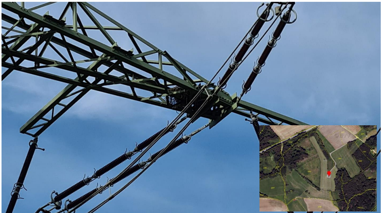
Abb. 9: Besetztes Nest des Kolkraaben auf Hochspannungsmast auf dem Grundstück Fl. Nr. 2470 am 06.05.2024.
