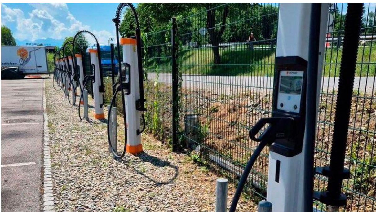
Abbildung 5: Schnellladesäulen exemplarisch, Kempower
